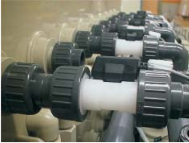
Elektronische Durchflussmengenmessung: Elektronische Kontrolle aller Sprührohre mit Alarmmeldung bei Abweichungen außerhalb der zulässigen Toleranz
