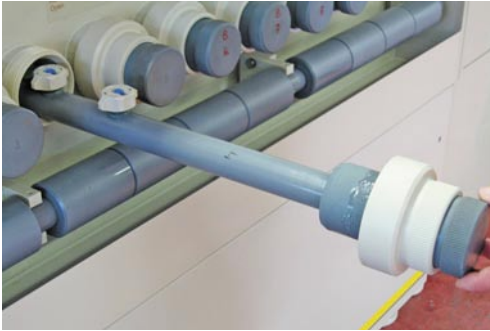
Abb. 3: Die quer eingebauten Düsenrohre lassen sich zu Wartungsarbeiten einfach und schnell ausbauen
